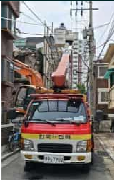
현지어건 문제점 대책 사례 - 해체작업중 굴착기가 전선을 단락시켜 복구
