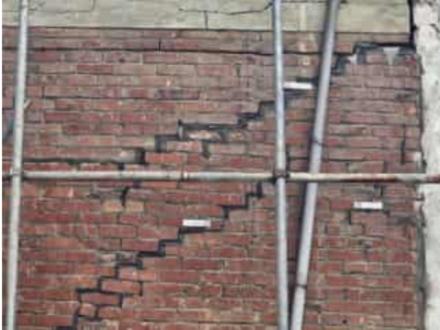
현지어건 사전조사시 문제점 사례 - 균열조사 미비로 추후 크랙게이지 부착
